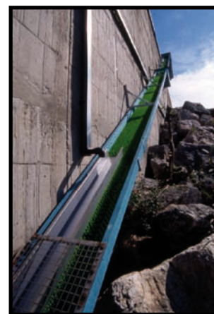
Figure 17 : rampes de reptation sur l'usine écluse de Beaucaire sur le Rhône (MRM)
